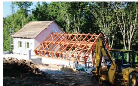
Aktuální pohled na čistírnu odpadních vod v Malečově – 24. 8. 2016.
