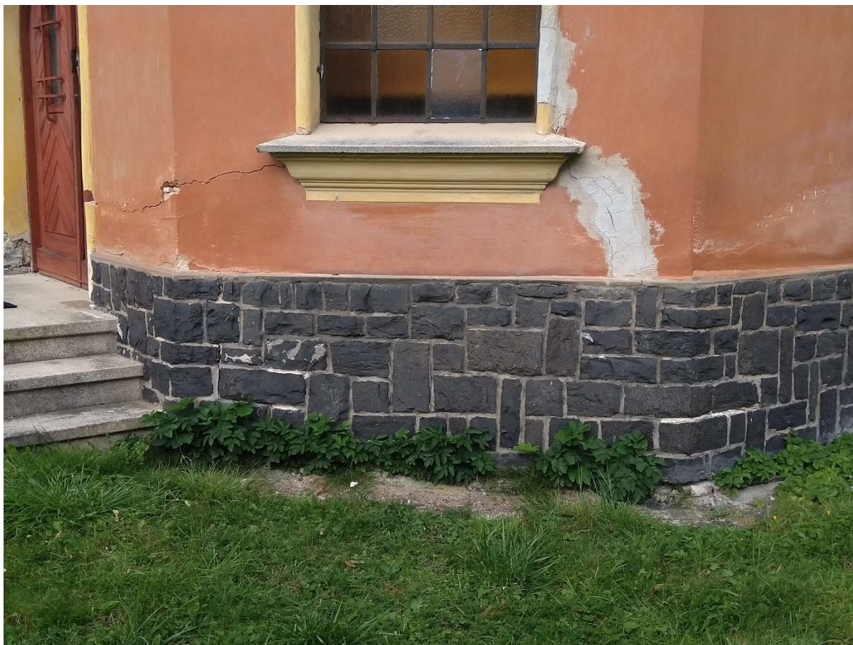
Trhlina v jihovýchodním průčelí předsíně
