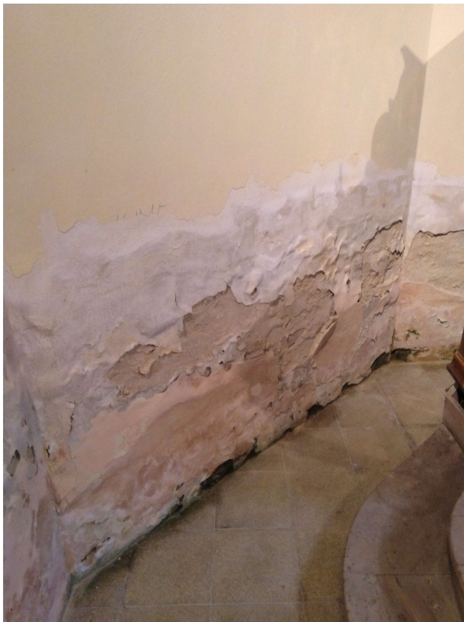
Vlhké zdivo v presbytáři
