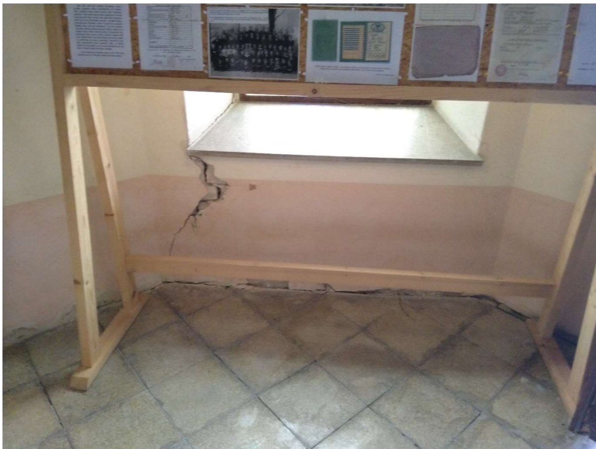
Stejná trhlina v interiéru
